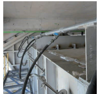
ЦЕМЕНТНЫЙ ЗАВОД, ВЬЕТНАМ КЛИНКЕРНЫЙ ХОЛОДИЛЬНИК
