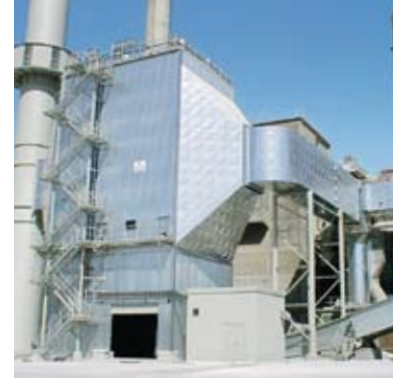
ZEMENTWERK , Deutschland WÄRMETAUSCHEROFEN/ ROHMEHLMÜHLE
