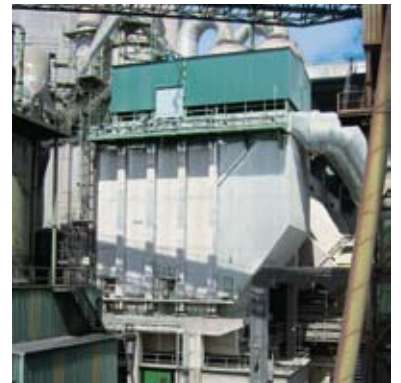
ZEMENTWERK, Spanien WÄRMETAUSCHEROFEN
